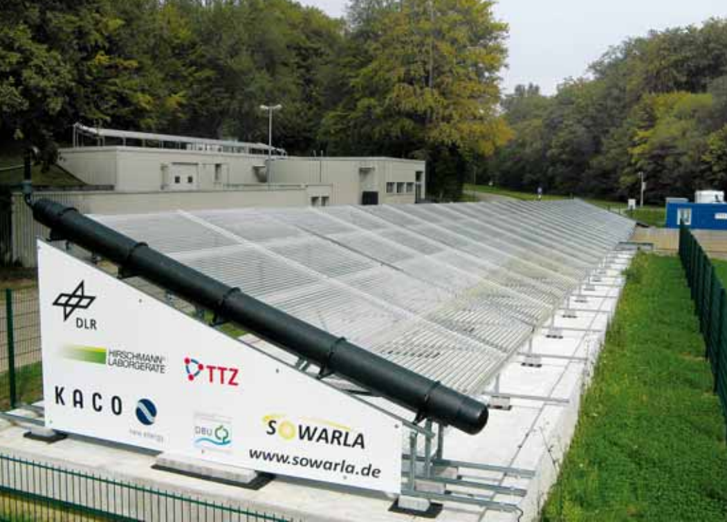
◀ Abbildung 1 238-m 2 -Solarreceiver der Demonstrationsanlage zur solaren Wasserreinigung
