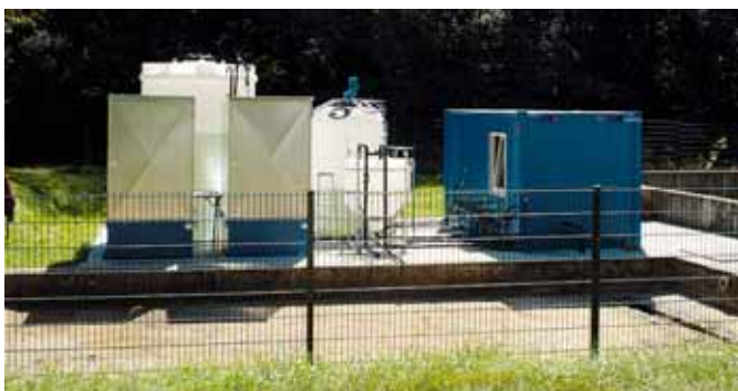
▼ Abbildung 4: Leitwarte und Vorratsbehälter
