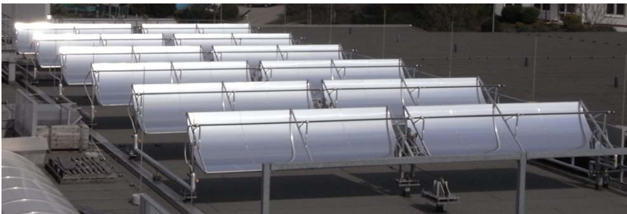
Abbildung 1: Solarfeld mit 108m 2 Parabolrinnenkollektoren
