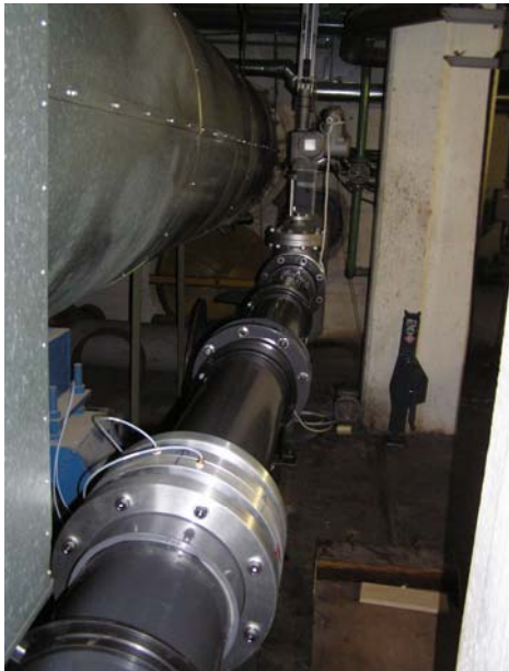
Abb.1 Rohrstrecke mit Messblende (vorne) und Drosselschieber (hinten)
