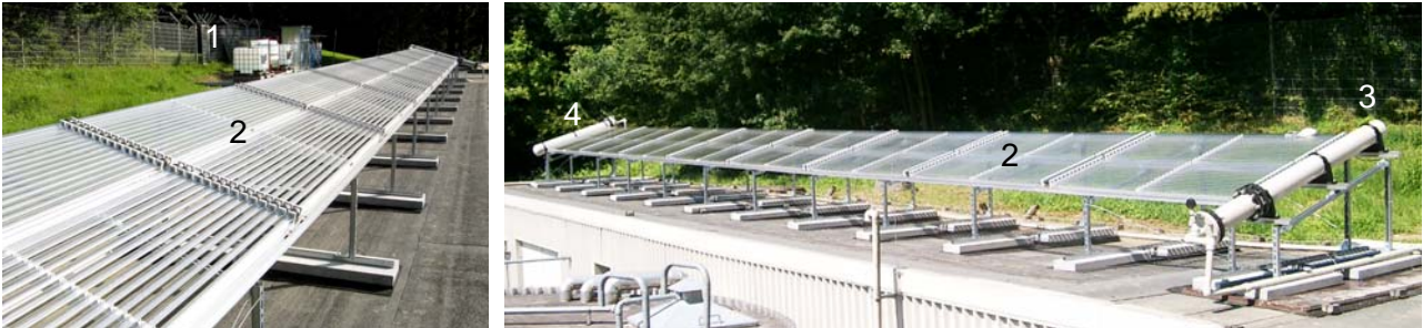
Abbildung 1: 32 m 2 solare Wasserreinigungspilotanlage auf dem Dach der Lampoldshausener UV-Oxidationsanlage, 1 Betriebsperipherie (Tanks, etc.), 2 Solarer Rohrreceiver, 3 Wasserverteiler, 4 Wassersammler
