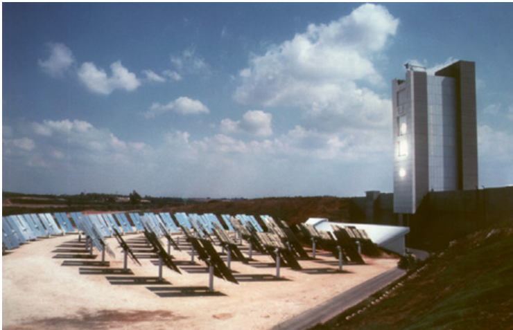
Solarturm-Testanlage Weizmann Institut, Israel
