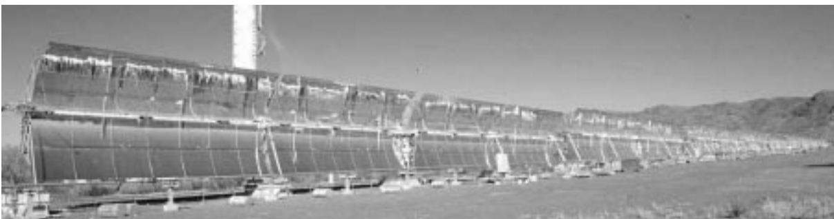
Abb. 2-5: Kollektorstrang der DISS-Testanlage auf der PSA
