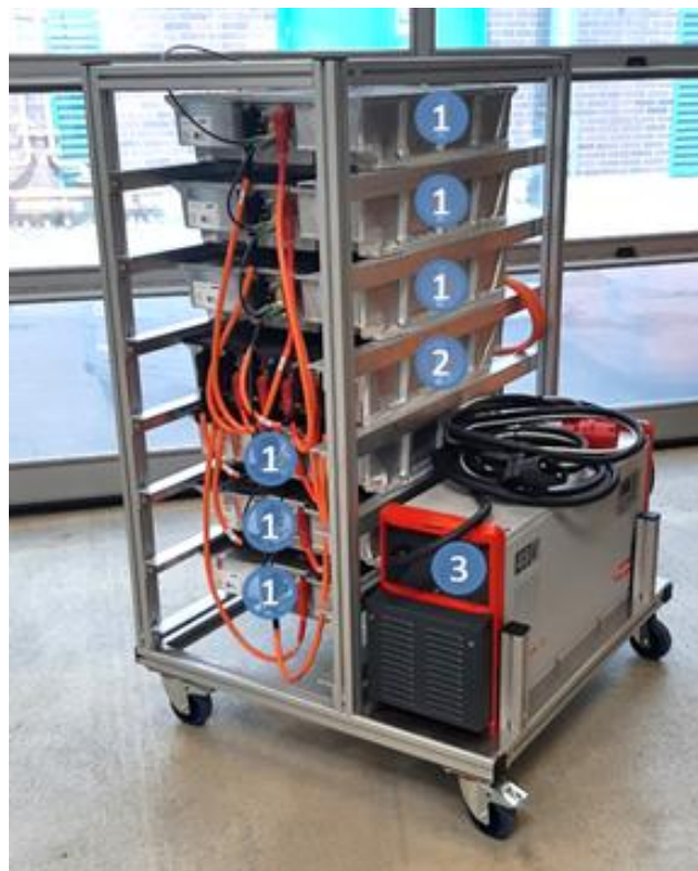
Abbildung 25: Mobiler Testaufbau des Batterieracks (1: Batteriemodule, 2: BMS Modul) und des Ladegeräts (3)
