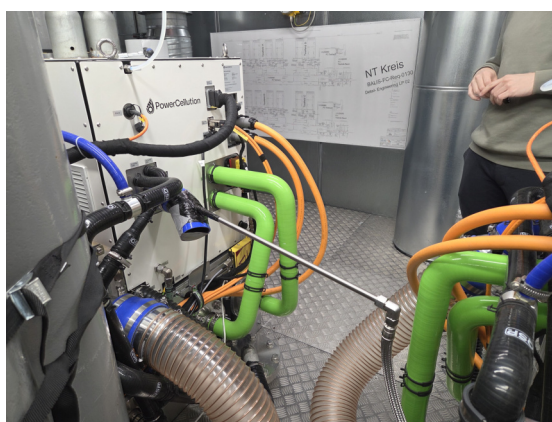
(a) Anschluss der N 2 -Versorgung von A3A4 an den Kathodeneinlass mittels Adapterstück
