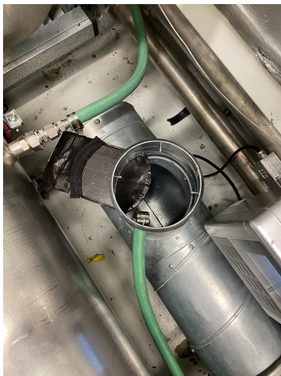
(a) Installierte Schiebeklappe zur Blockade der Kathodenluft
