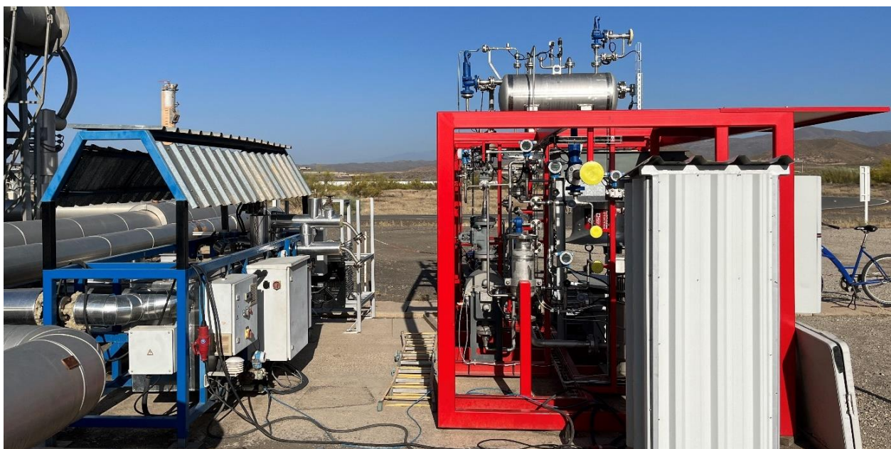
Abbildung 12: links (blau): Durchflusskalorimeter KONTAS-cp, rechts (rot): Mess-Wärmeübertrager an der PROMETEO-Anlage, die hydraulische Verbindung zwischen den Maschinen fehlt noch.
