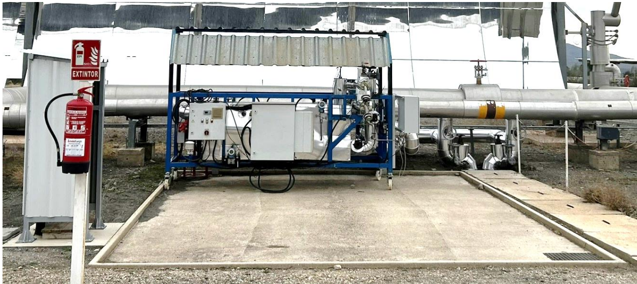
Abbildung 8: Durchflusskalorimeter KONTAS-cp an der PROMETEO-Anlage
