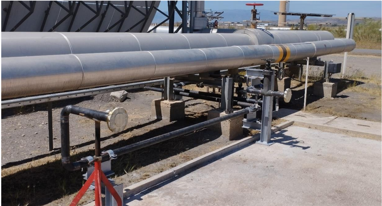
Abbildung 2: 2"-Rohrleitungsanschlüsse ohne thermische Isolierung für die Verbindung der PROMETEO-Anlage mit dem Mess-Bypass
