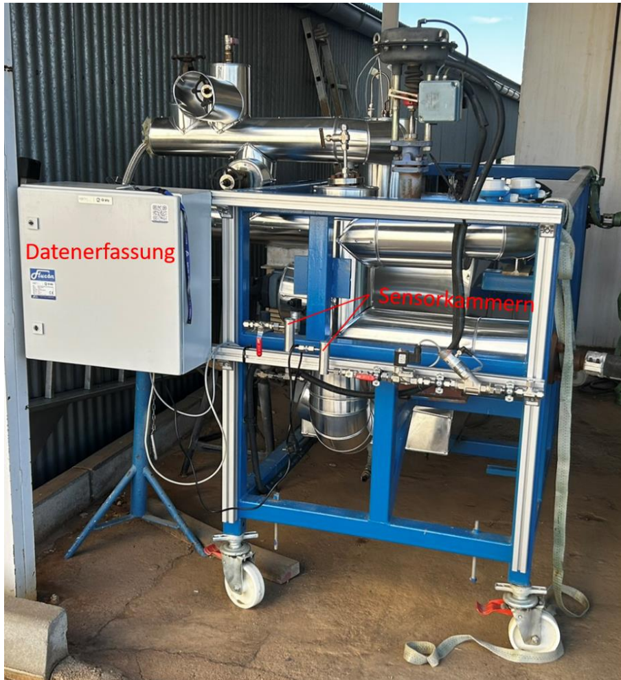
Abbildung 23: H2Online-System und Q-Vis-Viskosimeter während der Installation an KONTAS-cp
