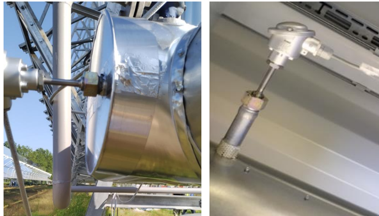
Abbildung 54: PT-100 Temperaturmessungen: Links Hülse zusätzlich bis zur Verschraubung isoliert, rechts nur Rohrisolierung
