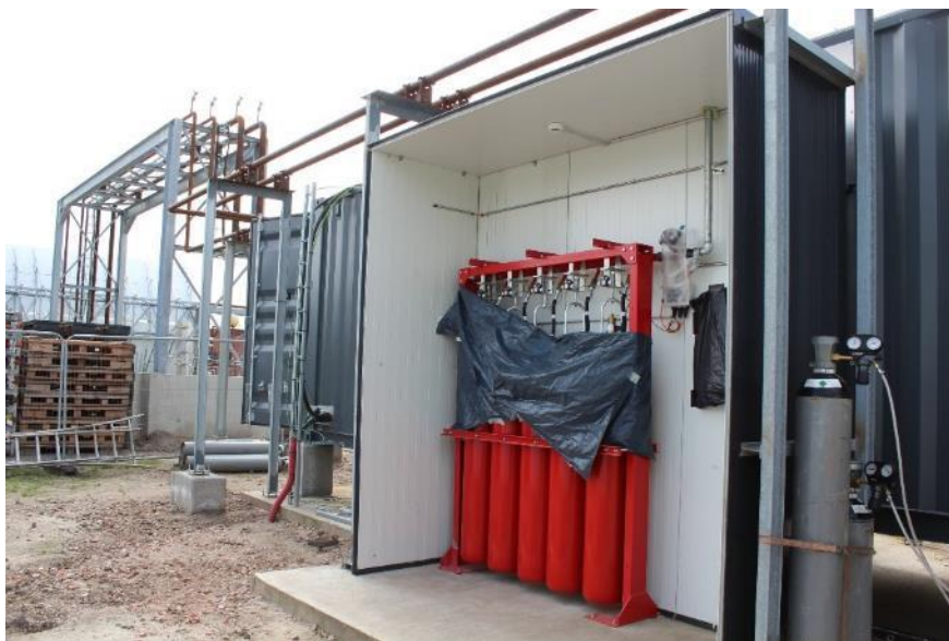
Abbildung 46: Löscheinheit an der BoP
