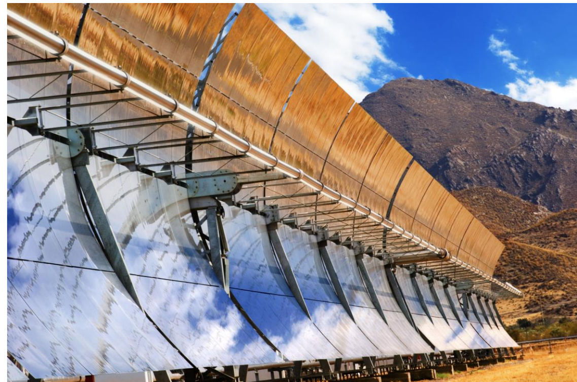
Eurotrough Kollektor: 5.76m x 148.5m Plataforma Solar de Almería (Eigentümer: Forschungszentrum CIEMAT/Spanien.) Quelle: DLR
