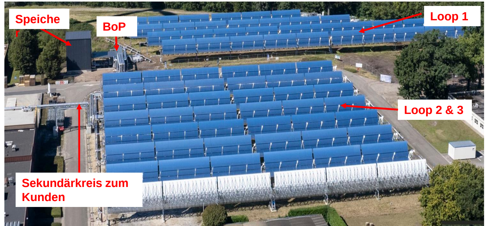
Solarkollektorfeld von Solarlite, Deutschland Energieübertragungsstation (BoP) und Speichertank (Foto: Avery Dennison)
