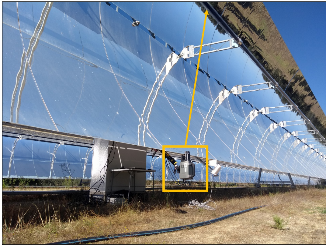
Abbildung 4.2.: Infrarot-Thermografie des Receiverrohrs in einer Parabolrinnenanlage auf der Plataforma Solar de Almería (PSA) [35]
