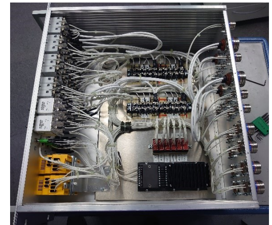
Stromverteiler FL2021 (DLR FL -Entwicklung)
