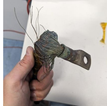
Abbildung 18: korrodiertes Kupferkabel der Impedanzheizung vor Überarbeitung des Teststandes
