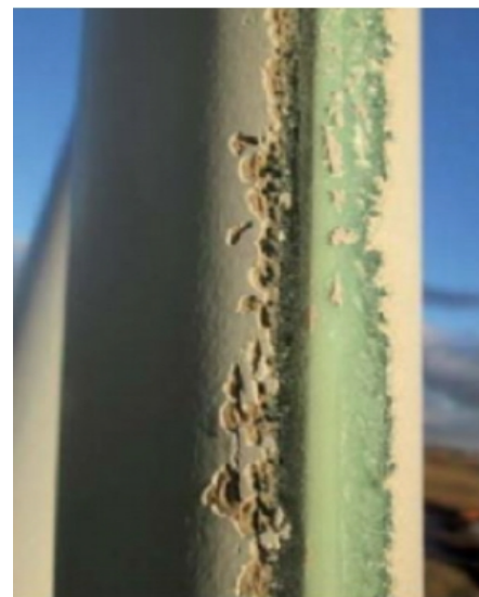
Abbildung 2.2: Großflächiger Abtrag der Oberflächenschicht und Beschädigung des Verbundwerkstoffs [2]
