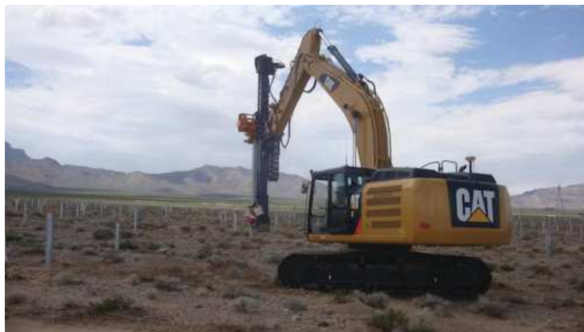
Abbildung 1.11.: Vibrationsrahmen der Pylonen der Heliostaten des Ivanpah Solar Electric Generating System durch die Firma BrightSource Energy, Inc. [For13].
