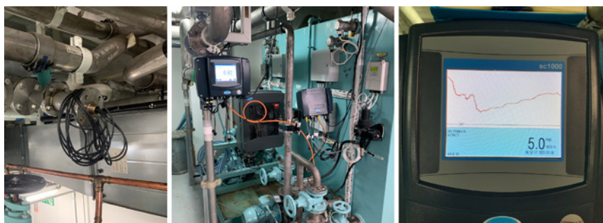
Abb. 3: An Bord installierte Messtechnik zur Überwachung der biologischen Prozesse in der Schiffskläranlage - links: Sondeneinbau in Rohrleitung mit in OSCAR entwickeltem Adapter, Mitte: OSCAR-Monitor direkt an der Anlage, rechts: Live-Messwertanzeige
