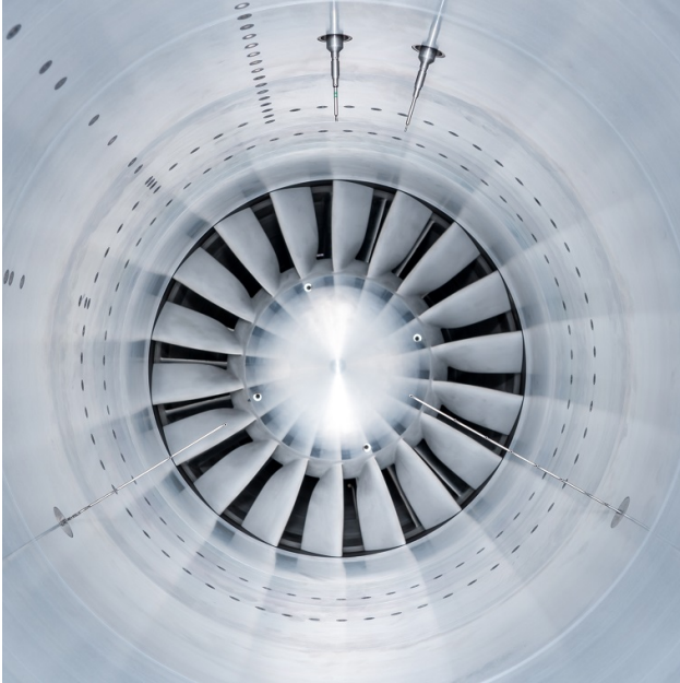
BILD 3. Ansicht der aerodynamischen und akustischen Messstellen in der Einlaufstrecke
