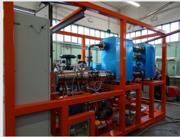
ORC Turbine mit 60 kWel Leistung
