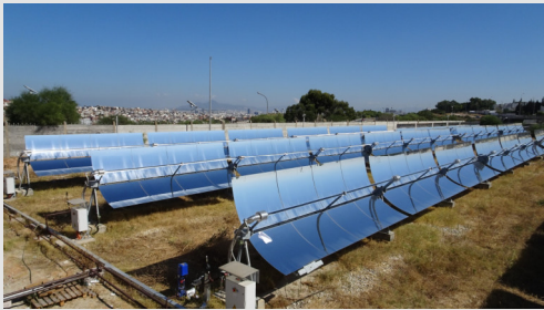
Kollektorfeld mit 1000 m² Kollektorfläche
