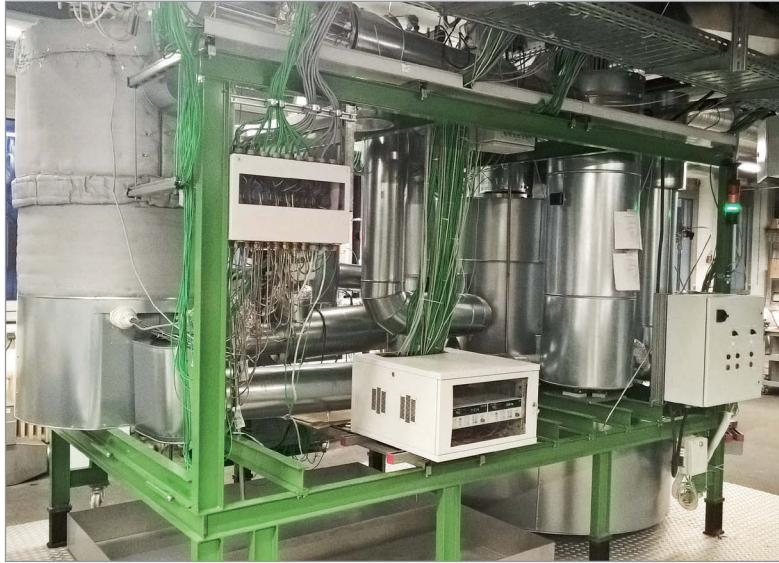
Abbildung 3 Ein-Tank-Speicherteststand für Salzschnmelzen des Fraunhofer ISE. Eine sehr gute Schichtung der Salzschnmelze im Speicher (links im Bild) konnte erfolgreich nachgewiesen werden. Quelle Fraunhofer ISE
