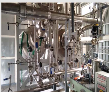
Receiver-Cluster mit Verrohrung und nachgeschalteter Peripherie
