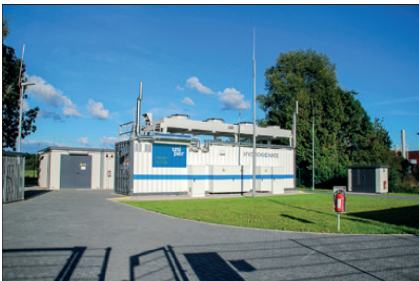
Abb. 5: PEM-Elektrolyse in Hamburg-Reitbrook nach Inbetriebnahme
